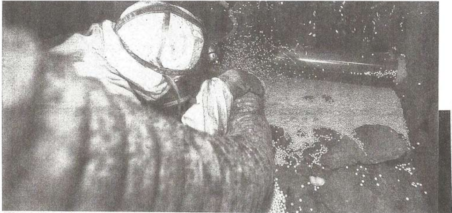
Hersilia spuit de miljoenen korreltjes piepschuim onder de kruipruimte van een van de woningen.
